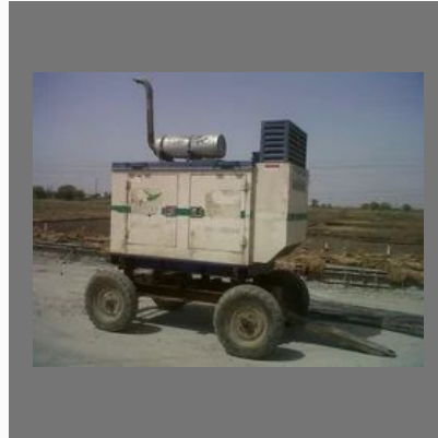
25 KVA DG Set
