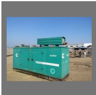
125 KVA DG Set
