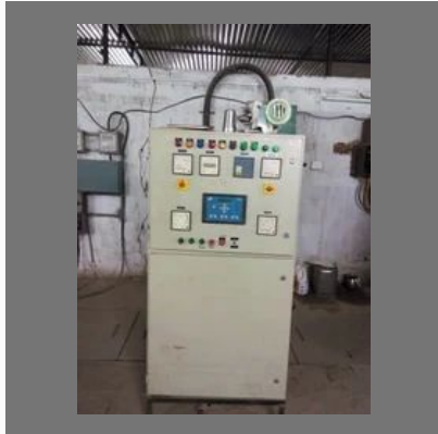
250 KVA AMF Panel
