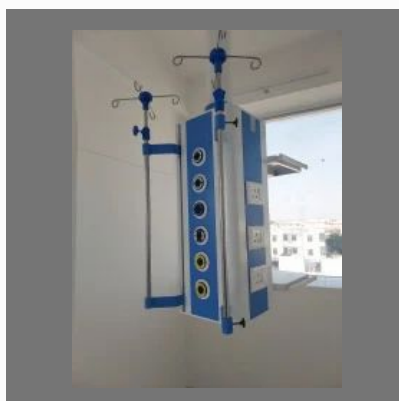
Ceiling Pendant System
