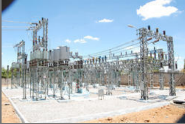
EHT & HT Transmission lines
