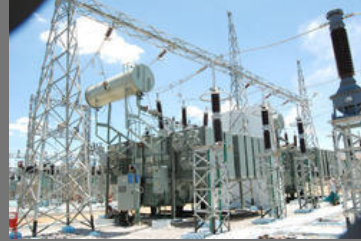
EHT & HT Sub-Stations Works
