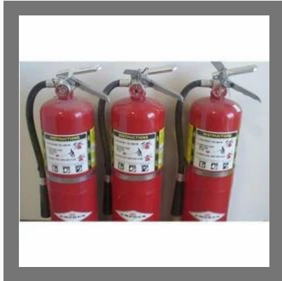
CO2 Type Fire Extinguisher
