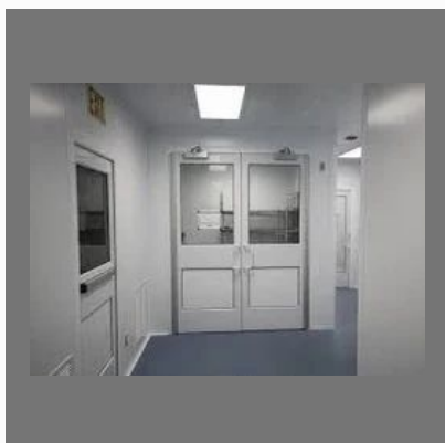
Clean Room Double Door
