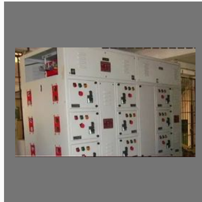
Ltmv Switchgear Panel
