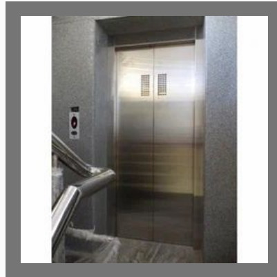
Elevator Auto Door
