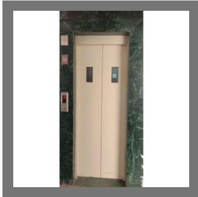
Automatic Elevator Door
