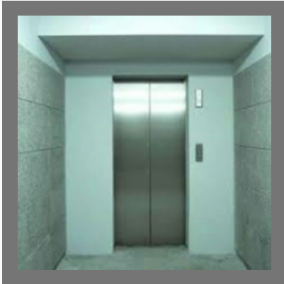
Automatic Door Elevator
