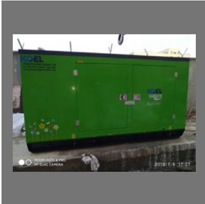
10 KVA Diesel Generator
