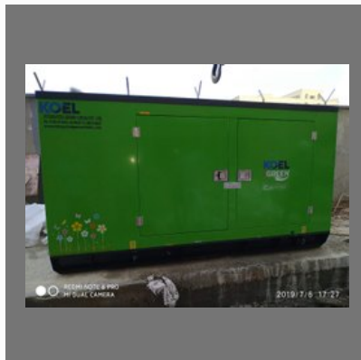
30 KVA Diesel Generator
