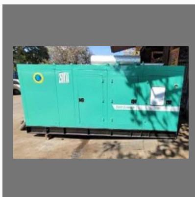
250 Kva Diesel Generator
