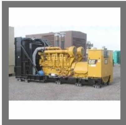
1010 KVA Caterpillar Generator Set
