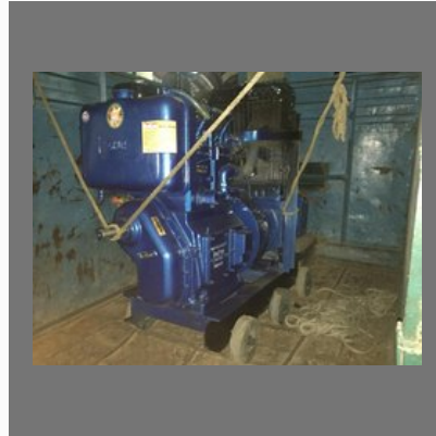
15 kVA Diesel Generator
