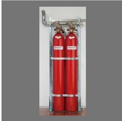
FM200 Fire Suppression System (Siemens Sinorix)
