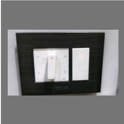
Ceiling Fan Switch
