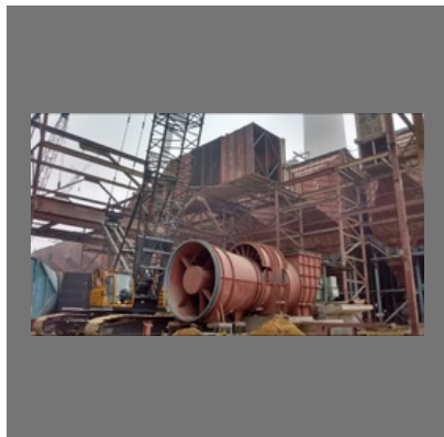
Boilers PA Fan
