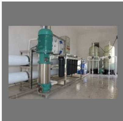
6000 lph R.O Plant
