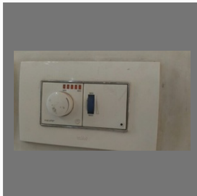
Fan Regulator Switches
