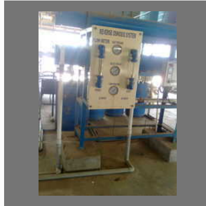
Effluent Treatment R.O System
