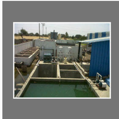
ETP, STP, UF and RO Plants
